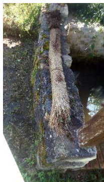
Une racine obstruait entièrement le tuyau
